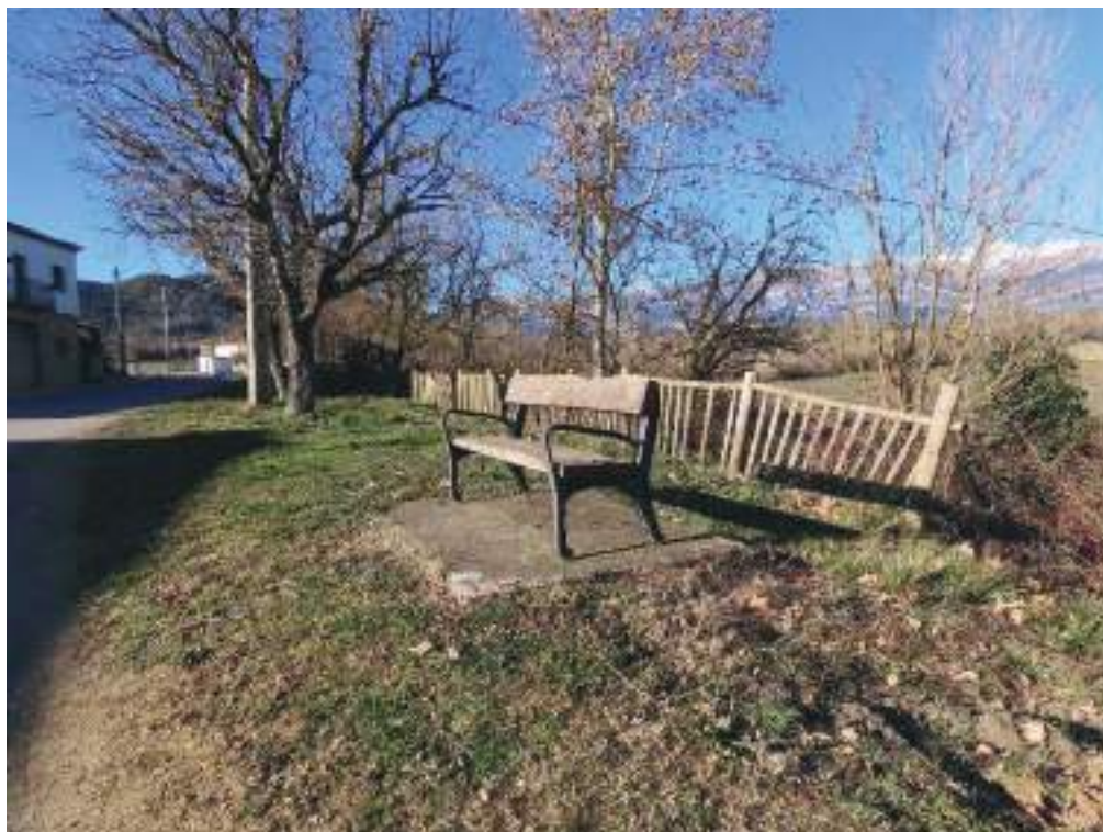
Imagen 44: Otra medida a proponer sería arreglar y adecuar las ya existentes instalaciones de embellecimiento y estancia entorno a este núcleo, como este vallado de madera que necesita algunas reparaciones.
