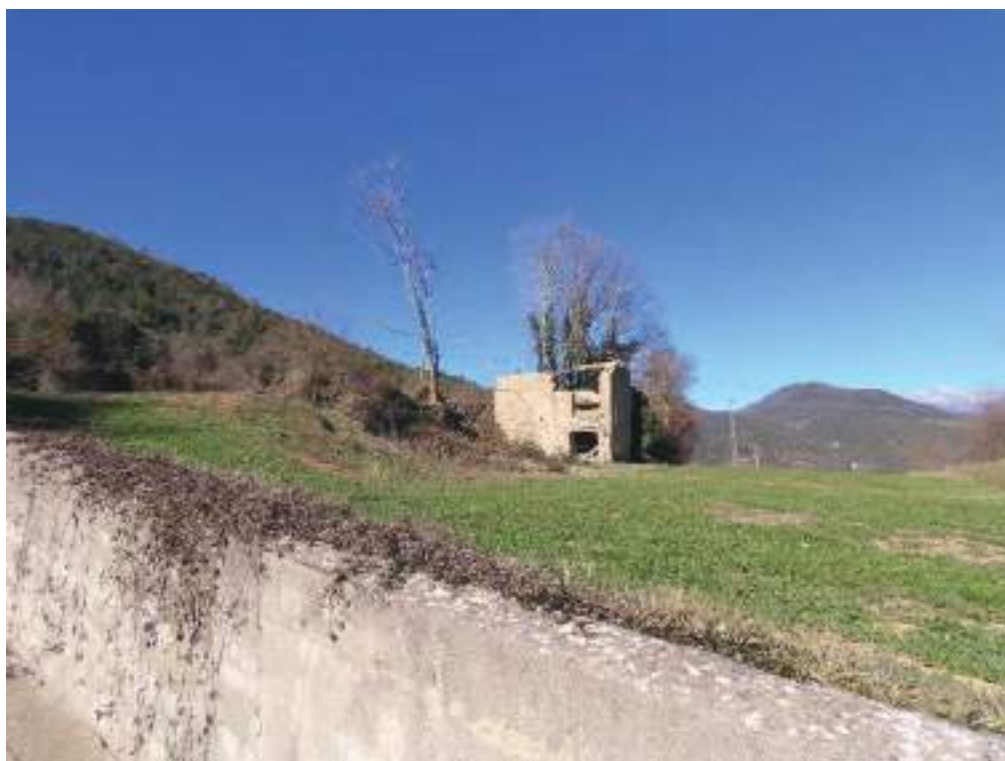
Imagen 19: Más ejemplos de muros de hormigón que podrían ser más estéticos colocando especies de hiedra o similares, en este caso al final de la Calle del Lavadero.
